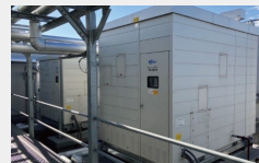
吸収冷温水機(奥) 排熱投入型吸収冷温水機(手前)
