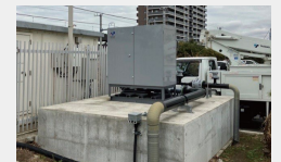
中圧ガス専用ガバナ 浸水対策のため嵩上げを実施
