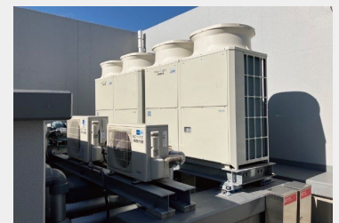
電気空調設備
