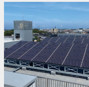
太陽光発電設備
