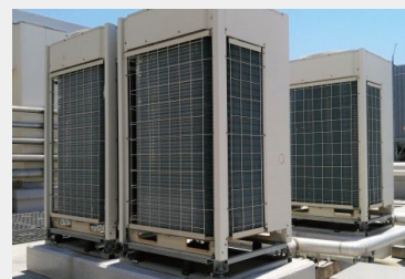
電気空調設備 *2
