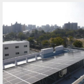
太陽光発電設備
