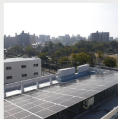
太陽光発電設備
