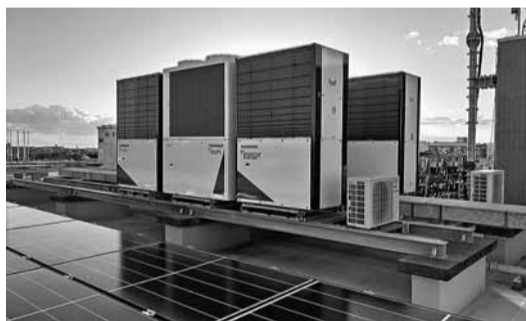
空調容量を54%削減し、設置面積も格段に小さくなった
