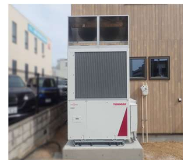
電源自立型GHP 56kW 1台
