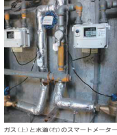
ガス(L)と水道(印)のスマートメーター
