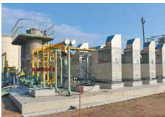
25機消化ガスジョージェネが12おざらりと並んでいる
