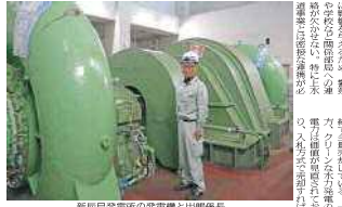
新飯巴谷発電所の発電機と出帆機
