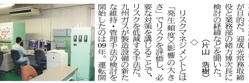
津久葉工場の監視制御室
