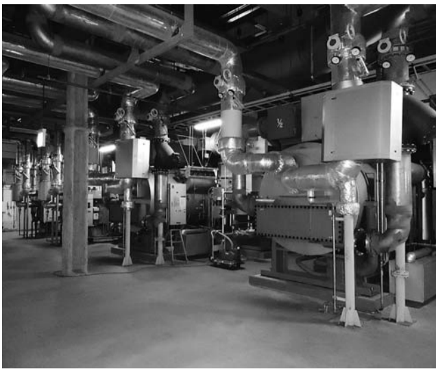
商業施設に導入した吸収式冷温水機(津山ガス)
