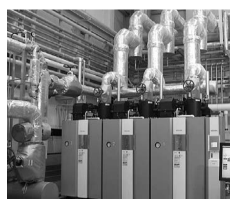
北条工場のボイラー運転デモルーム
